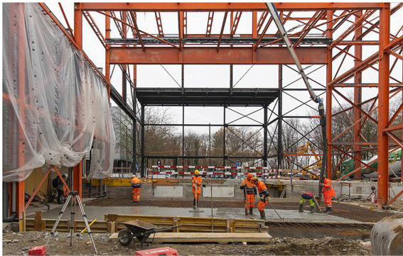
Il ne reste plus de la salle Apothélos que la charpente métallique. ODILE MEYLAN
